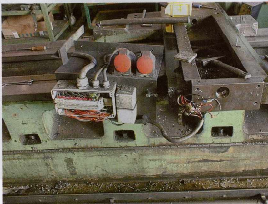
□ 5: Völlig demolierte und funktionsunfähige Elektrik zeugt von langem Dornröschenschlaf
